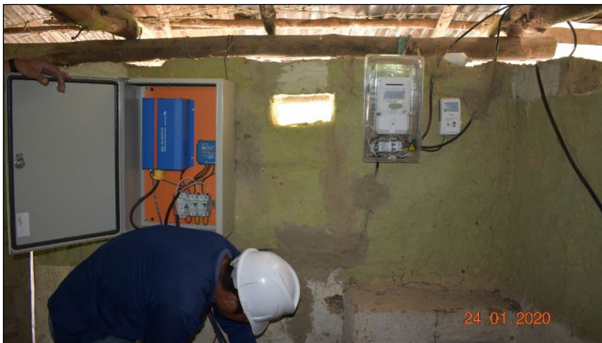
Imagen 27. Medidor Eléctrico Parroquia Pucapamba.
