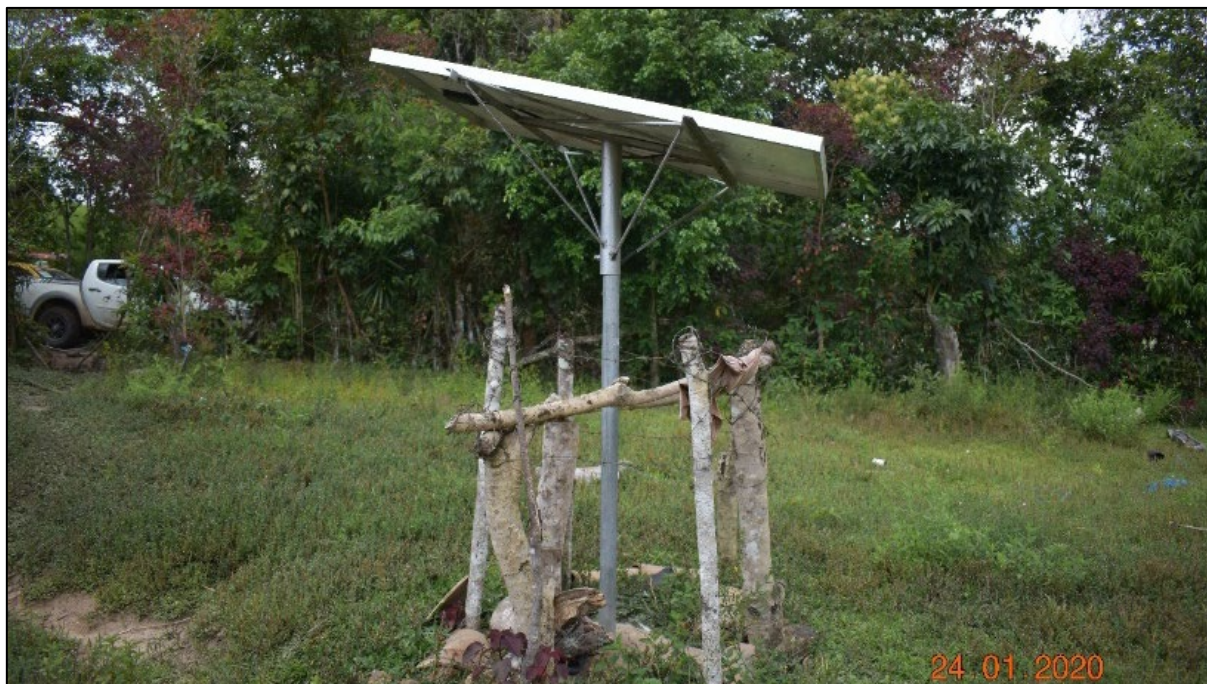
Imagen 26. Paneles Solares Parroquia Pucapamba.
