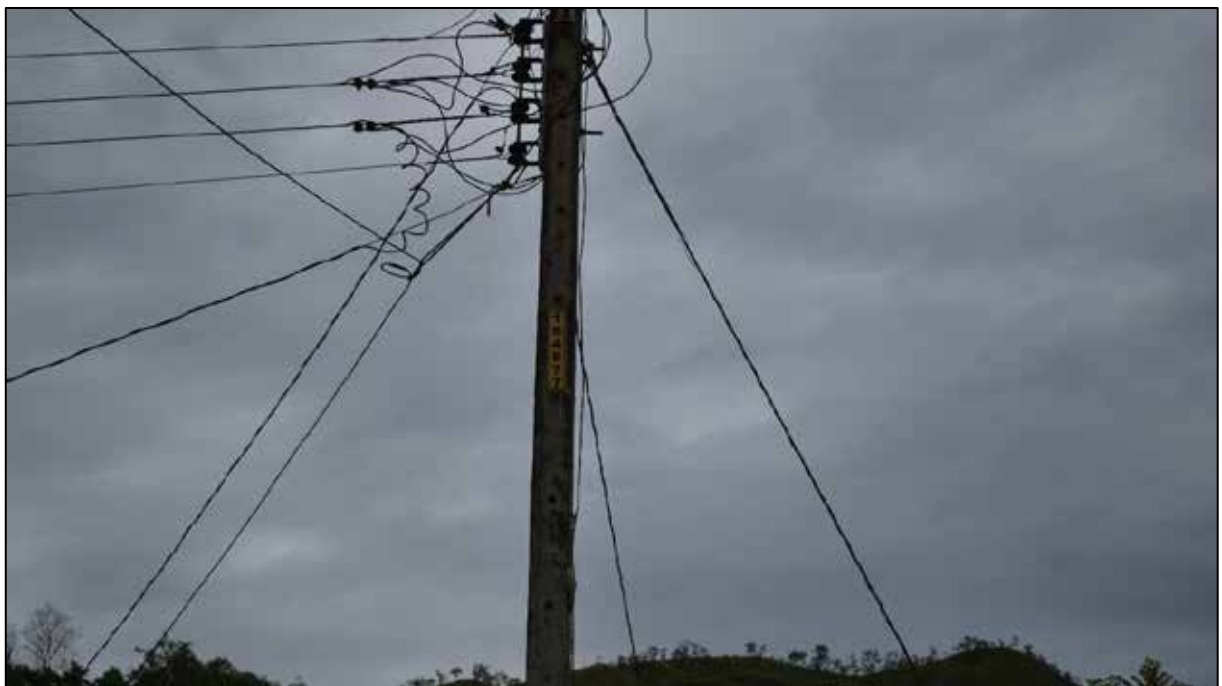
Imagen 25. Líneas de Energía Eléctrica Baja Tensión.
